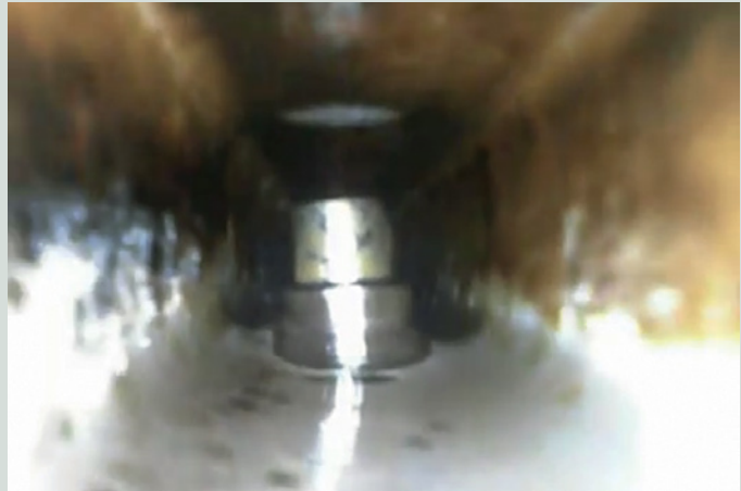
Abbildung 17: Einblick in eine Nippeltränke – während am Boden das helle Material der Leitung noch sichtbar ist, zeichnet sich der Biofilm im Rest der Leitung deutlich durch seine bräunliche Farbe ab. (© AGRAVIS Raiffeisen AG)
