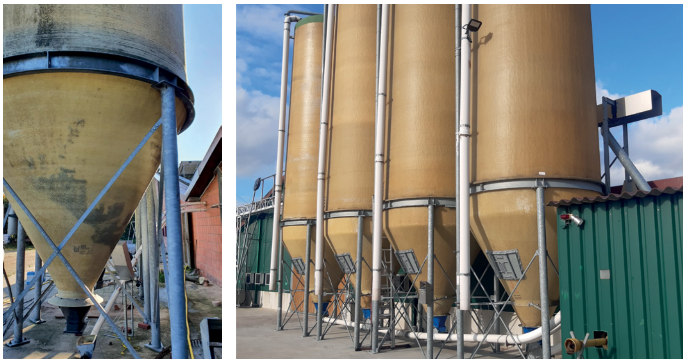
Abbildung 9 a+b: Auf dem linken Bild ist ein Silo zu sehen, bei dem sich Futterreste an den Wänden abgelagert haben. Hier sollte eine Reinigung erfolgen. Zudem liegen unter dem Silo mehrere Gegenstände, die Schädigern und anderen Schädlingen Rückzugsmöglichkeiten bieten. (© AGRAVIS Raiffeisen AG) Auf dem rechten Bild weisen die Silowände keine Verschmutzungen auf. Die Fläche unter den Silos ist frei von Gegenständen. Futterreste lassen sich bei Bedarf leicht entfernen. (© A. von Hugo).
