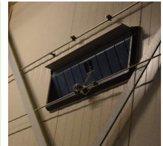
Sprühkühlung in der Junghennenaufzucht
